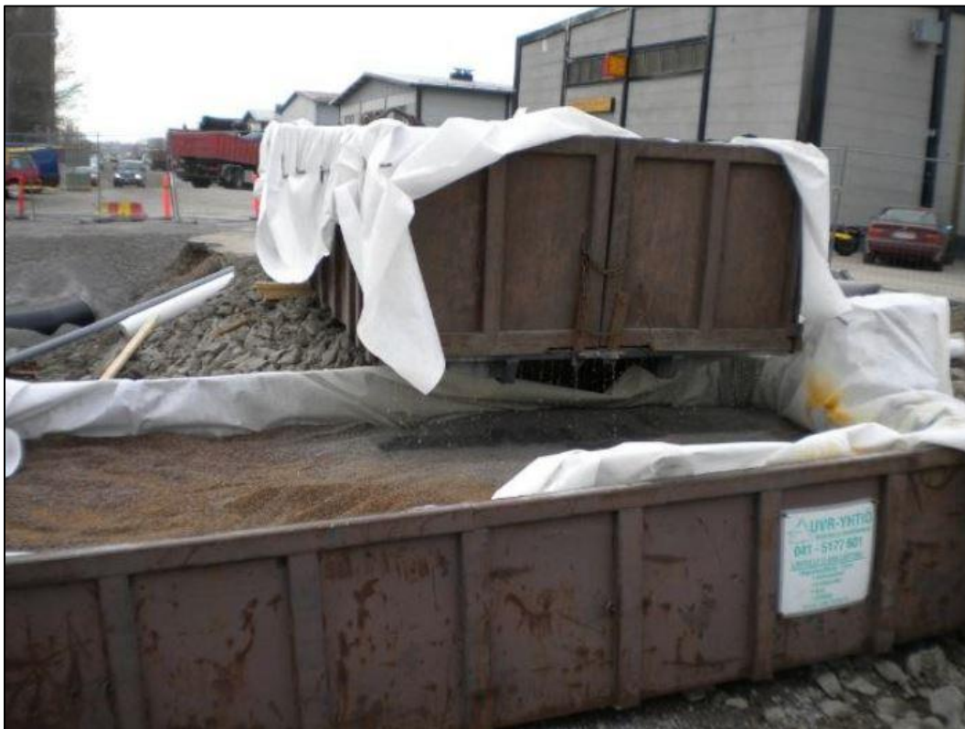
Kuva 11. Esimerkkikuva vaihtolavan sisään rakennetusta suodattimesta. 2
